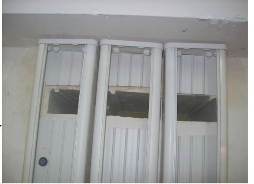
Sistem odası iç duvarı
